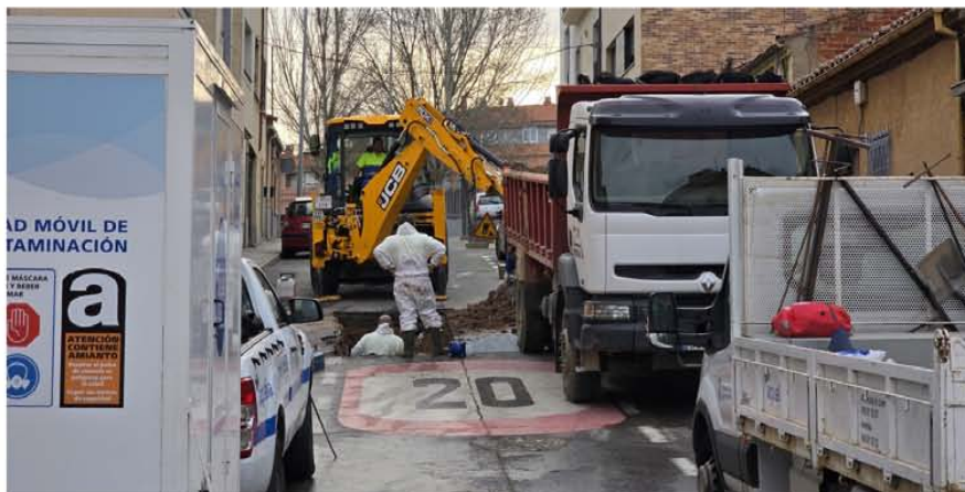
Rotura de una tubería en la calle Río Sil
