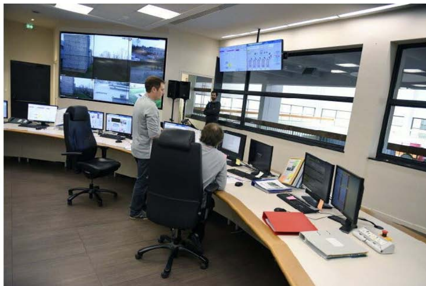
Sur le site de l'usine de traitement des eaux de Rillieux-la-Pape. Photo d'illustration Maxime Jegat
